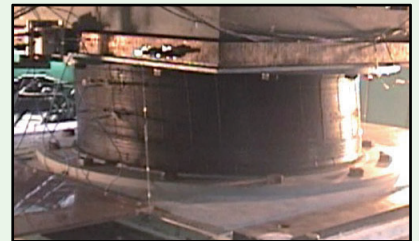
建物の下に設置されている免振ゴム
